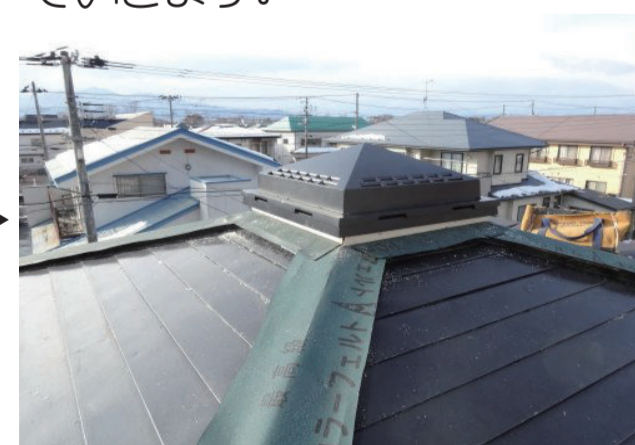
⑥てっぺん部に小屋裏換気部材を設置したところです。
