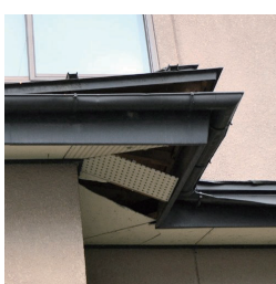
破損した屋根と軒天
